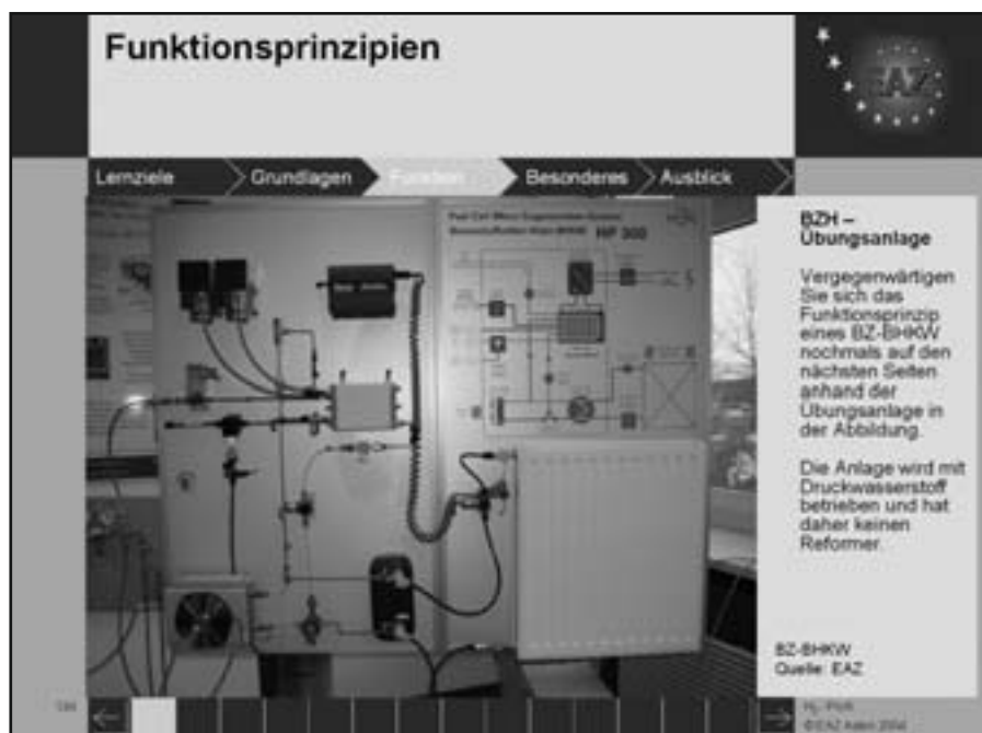
Abb. 3: Übersicht-Detail-Prinzip am Beispiel einer Heizungs-Demonstrationsanlage (1)
